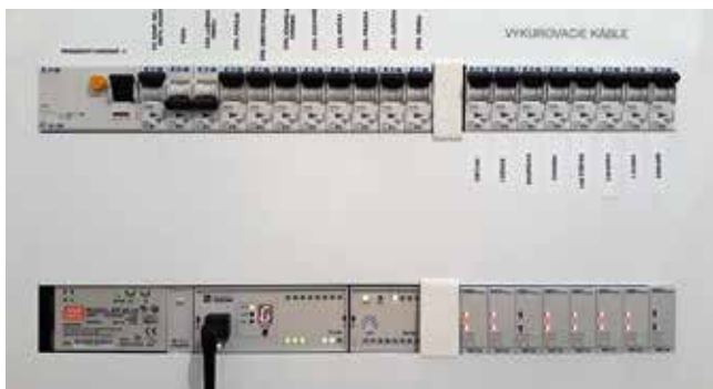
Ukážka inštalácie v domovom rozváždači
